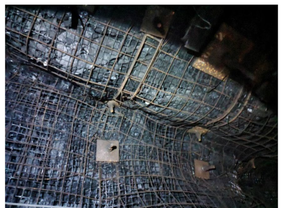
(d) Overall sinking of the roof
